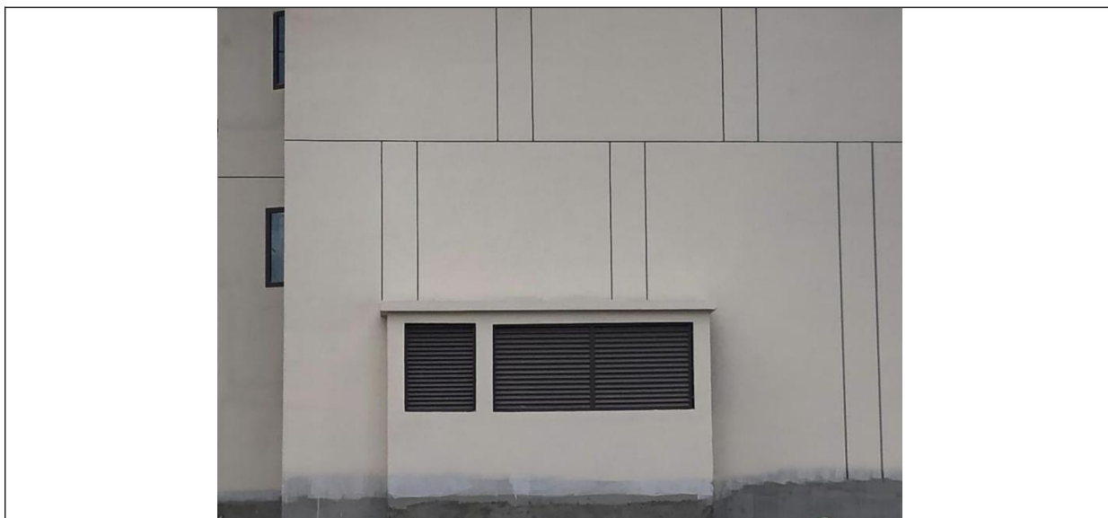
图 4-2 地下车库排风口
